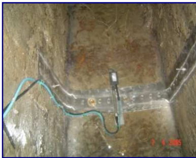
Instrumentation des réseaux avec des sondes hauteur – vitesse et de pluviomètres
